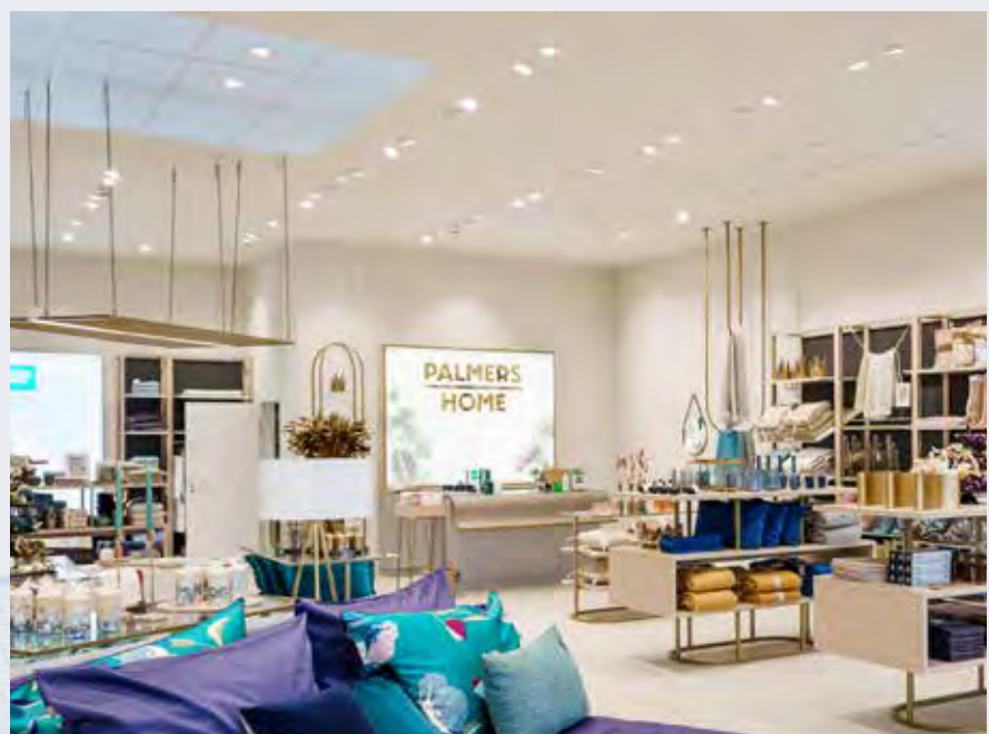
Trgovački centar PADO Shopping Galerien Parndorf, tvrtka CAVERION Österreich GmbH Klimaanlage und Wärmepumpen
