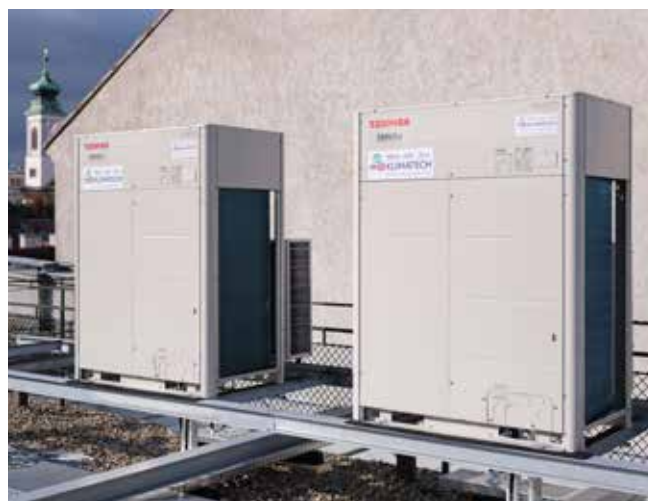
Uredi i prostorije tvrtke EDV, Windmühlgasse Beč, tvrtka Klimatech Wärme Kälte Klima
